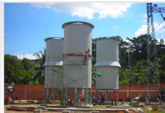
REACTOR DE NUCLEO DE AIRE TRENCH 5 MVar, 138 kV, 60Hz
