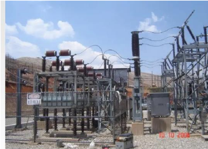
BANCO DE CAPACITORES DE 9.6 MVar, 50 kV
