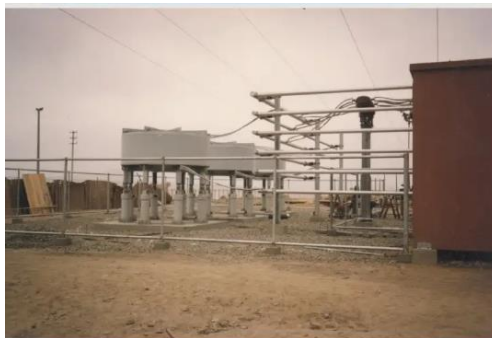
REACTOR CON NUCLEO DE AIRE DE 50 MVar SVC TRUJILLO
